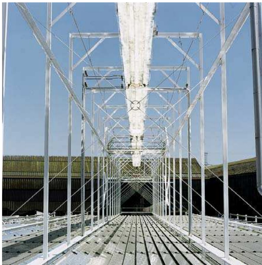
Σχήμα 5.3: 2500 m 2 πρωτότυπος σταθμός στην Liège, Βέλγιο
