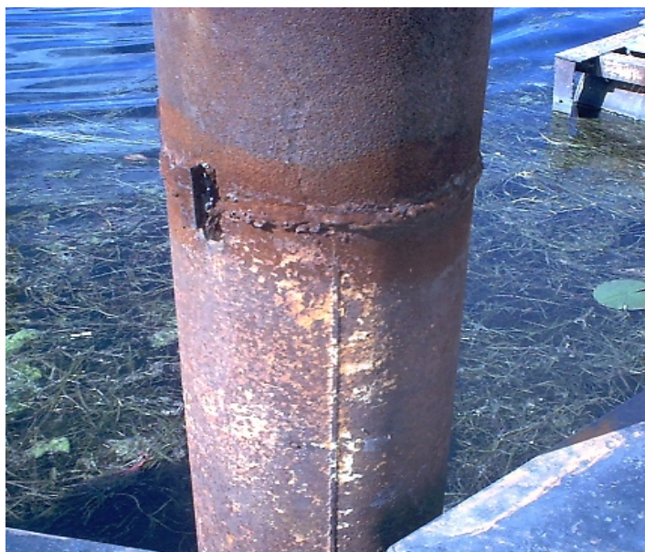
Φωτ. 2.1: ομοιόμορφη διάβρωση
