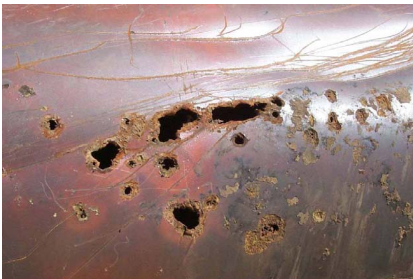
Φωτ. 2.3: Γαλβανική Διάβρωση.
