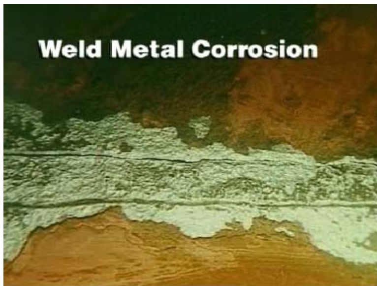
Φωτ. 4.2: Διάβρωση στην περιοχή της συγκόλλησης
