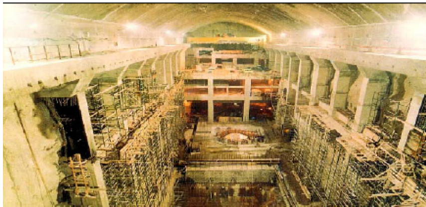
Εικόνα 3-20: Υπόγειος υδροηλεκτρικός σταθμός, Θησαυρός (ΠΗΓΗ: www.gew.gr/pages/cat14.htm )
