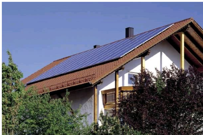
ΕΙΚΟΝΑ 43: Φωτοβολταικά πλαίσια σε στέγη
