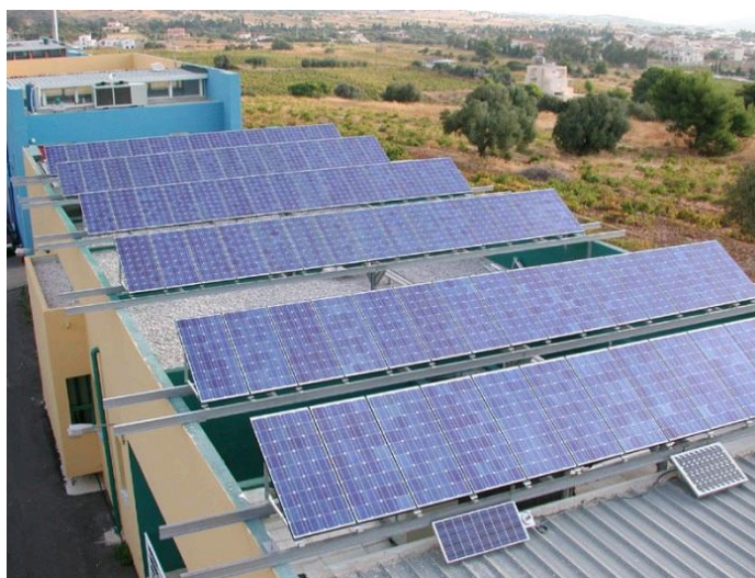
ΕΙΚΟΝΑ 44: Φωτοβολταικά πλαίσια σε δώμα (ταράτσα)
