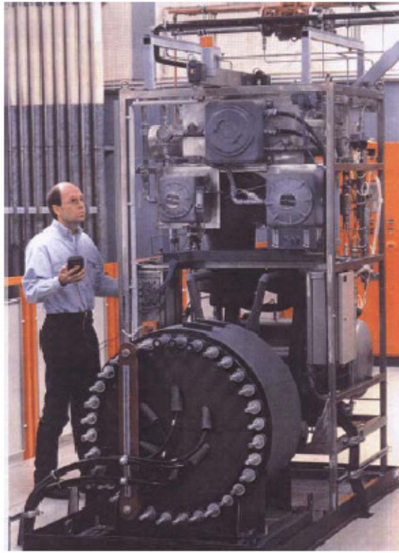
Σχήμα 3.11 Μονάδα ηλεκτρόλυσης 250 kW ei της CASALE στην Ελβετία
