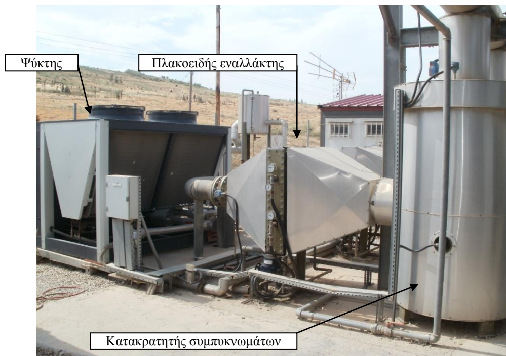
Εικόνα: Επεξεργασία βιοαερίου για το τμήμα 1 του σταθμού
