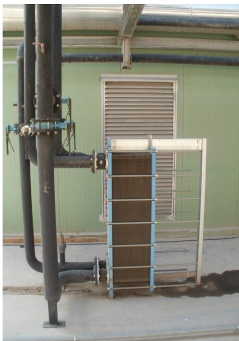
Εικόνα: Αποβολή θερμότητας νερού ψύξης προς εξατμιστή βιολογικού καθαρισμού
