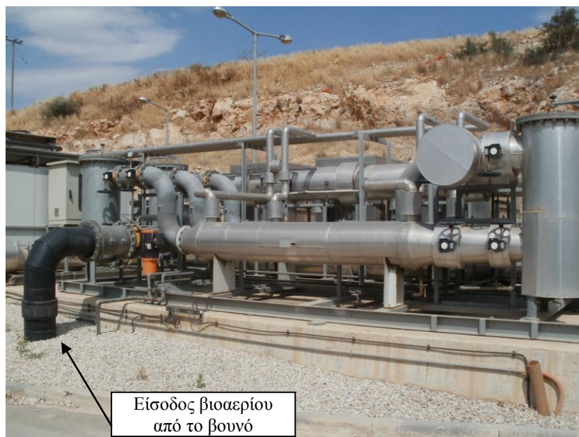
Εικόνα: Επεξεργασία βιοαερίου για το τμήμα 2 του σταθμού
