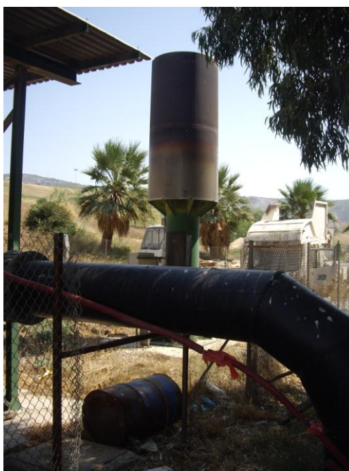
Εικόνα: Πυρσός καύσης στο ΧΔΑ Α. Λιοσίων
