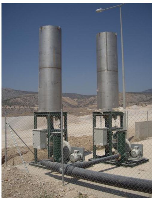
Εικόνα: Πυρσοί καύσης στο ΧΥΤΑ Φυλής
