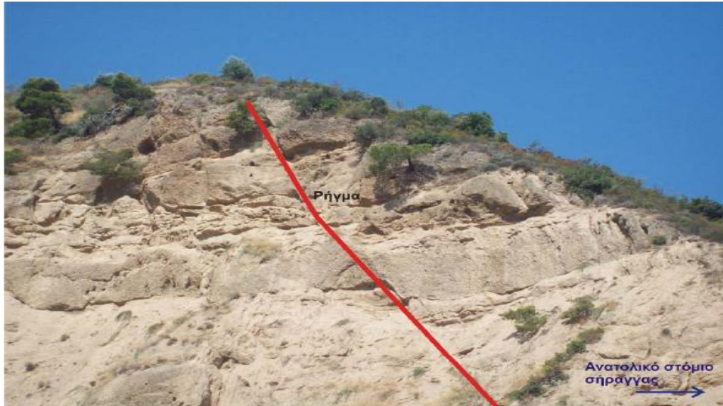
Φωτογραφία 2.1: Άποψη του ίχνους του ρήγματος Δερβενίου που επηρεάζει τα συνεκτικά κροκαλοπαγή νότια της σήραγγας στα Μαύρα Λιθάρια.
