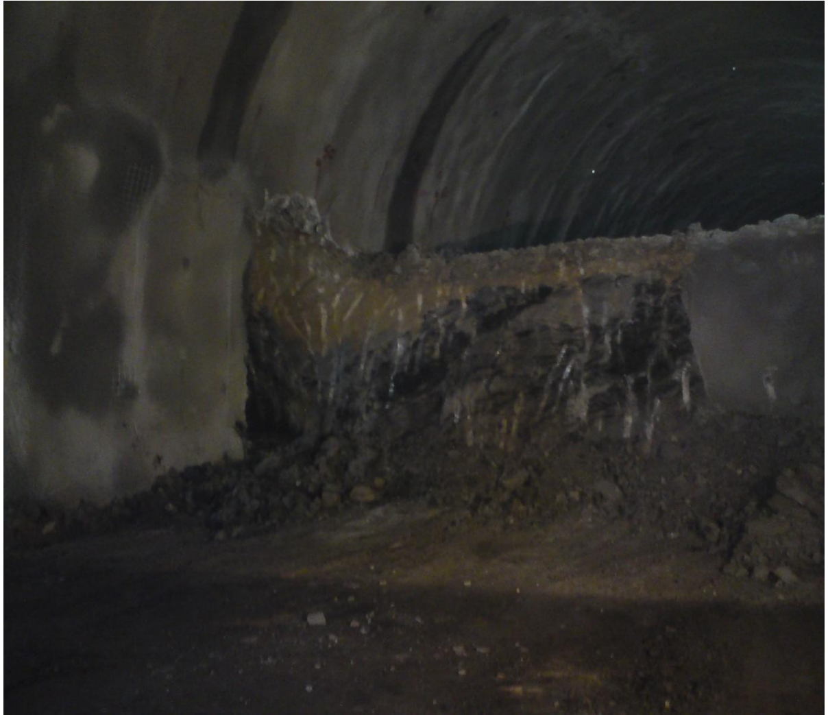
Φωτογραφία 5.2: Η εκσκαφή της ημιδιατομής έχει πραγματοποιηθεί και η εκσκαφή της βαθμίδας έχει αρχίσει
