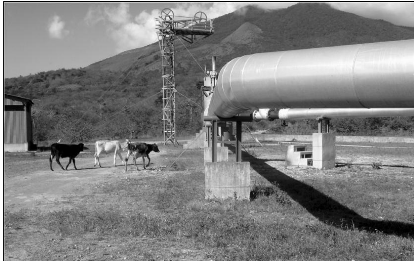
Εικόνα 1.25: Σωληνώσεις του γεωθερμικού σταθμού Miravalles, Costa Rica (Πηγή: R.Di Pippo, 2007. Geothermal Power Plants)
