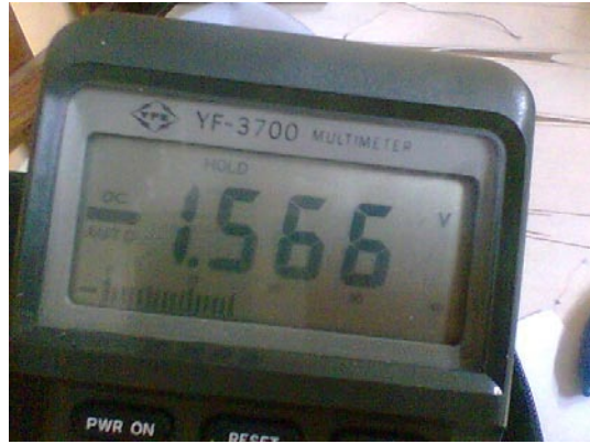
Εικόνα 61: Ένδειξη dc τάσης που τροφοδοτεί το πηνίο.
