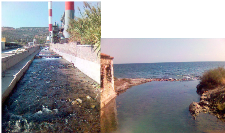
Σχήμα 3.4. Εξαγωγή του νερού ψύξης από το εργοστάσιο της ΔΕΗ.
