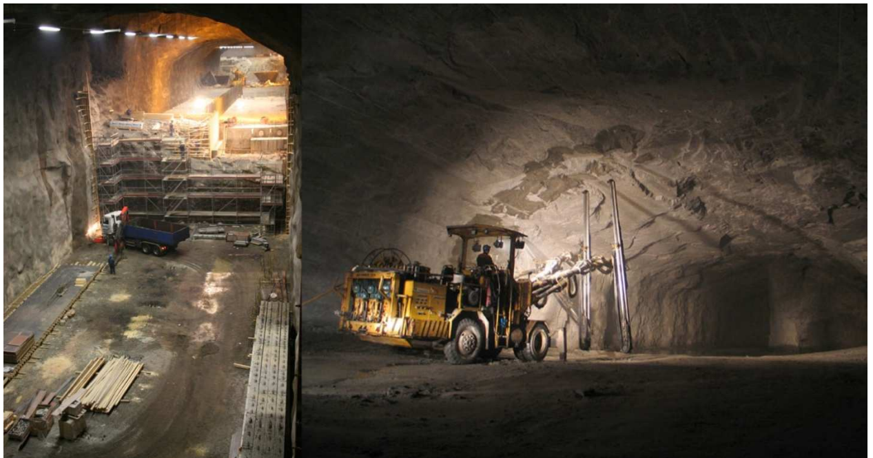
Εικόνα 2.1. Υπόγειες εγκαταστάσεις βιολογικού καθαρισμού λυμάτων στην Φινλανδία.
