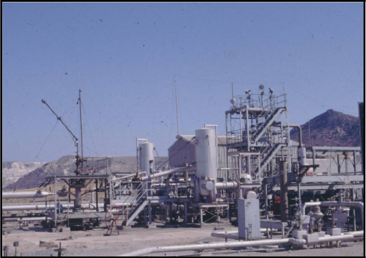
Σχήμα 4.15: Φωτογραφία της γεωθερμικής μονάδας της Μήλου (Πηγή: Φυτίκας, 2007)
