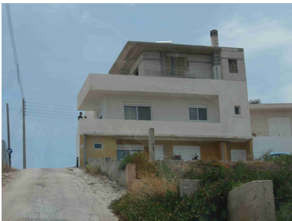
Εικόνα 2.5. Παράνομη κατασκευή τρίτου ορόφου σε εκτός σχεδίου περιοχή της Κερατέας όπου ο μέγιστος αριθμός ορόφων (όταν υπάρχει νόμιμη άδεια) είναι δύο
