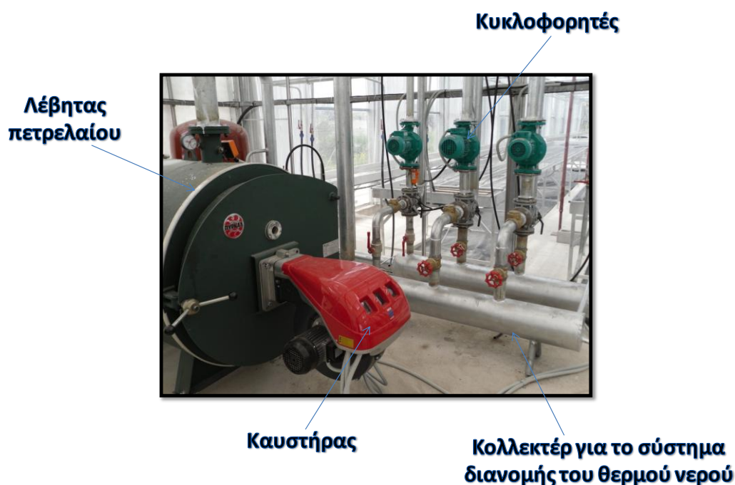
Εικόνα 3: Άποψη ενός τμήματος του λεβητοστασίου
