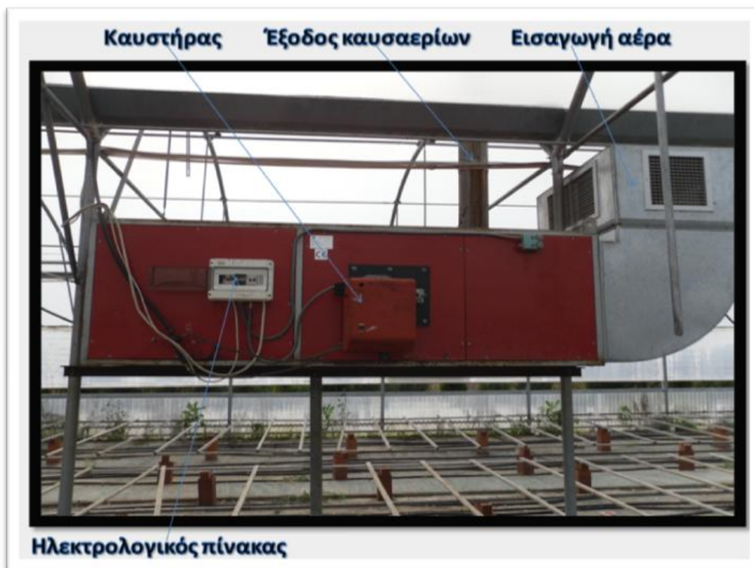
Εικόνα 1: Αερολέβητας πετρελαίου σε πλαστικό θερμοκήπιο ( www.meidanis.com.gr )
