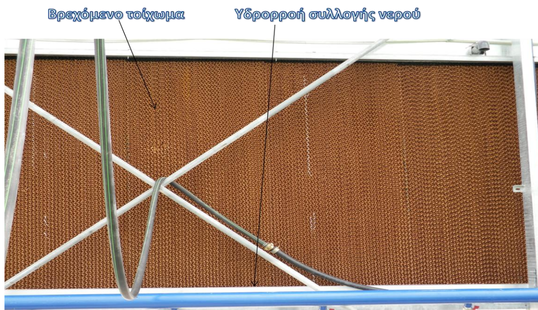
Εικόνα 15: Βρεχόμενο τοίχωμα συστήματος ψύξης
