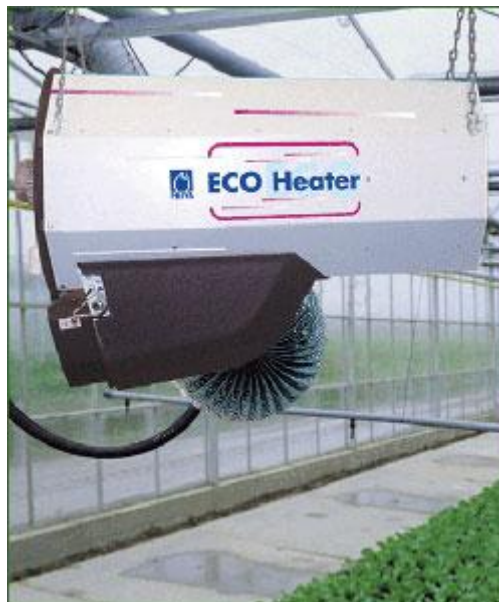
Εικόνα 22: Καυστήρας προπανίου της εταιρίας Priva (Priva) για παραγωγή CO 2 στο θερμοκήπιο
