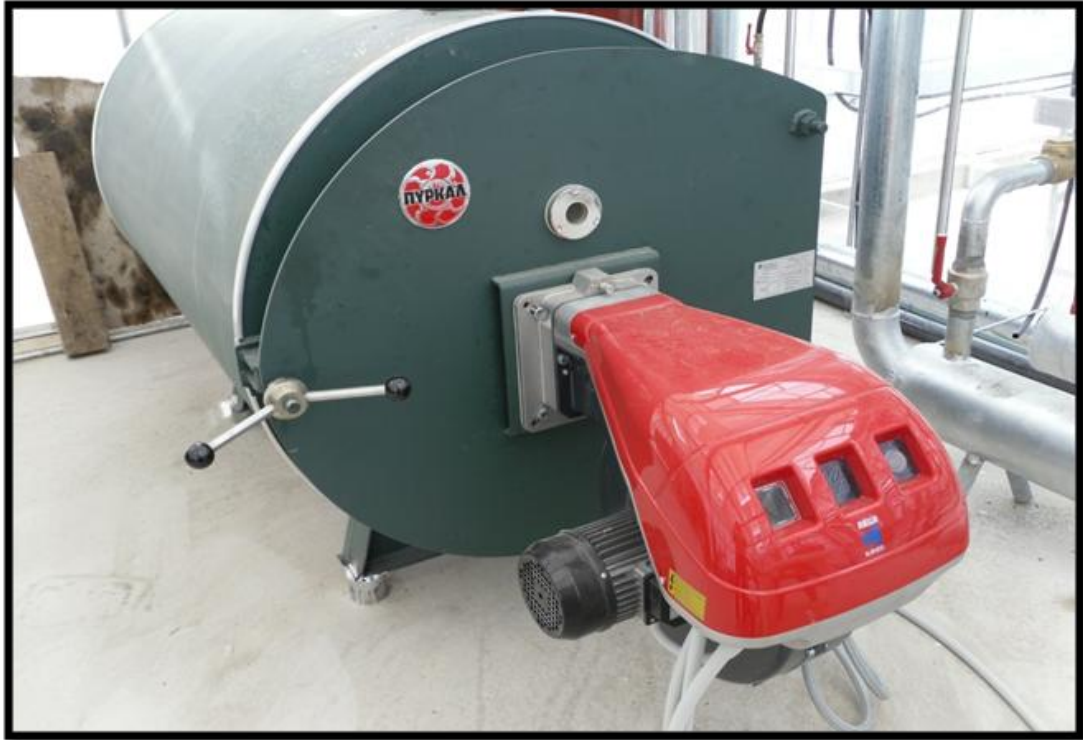
Εικόνα 2: Λέβητας πετρελαίου 700KW και καυστήρας τοποθετημένοι στο λεβητοστάσιο ( www.meidanis.com.gr ) (Πυρκάλ)
