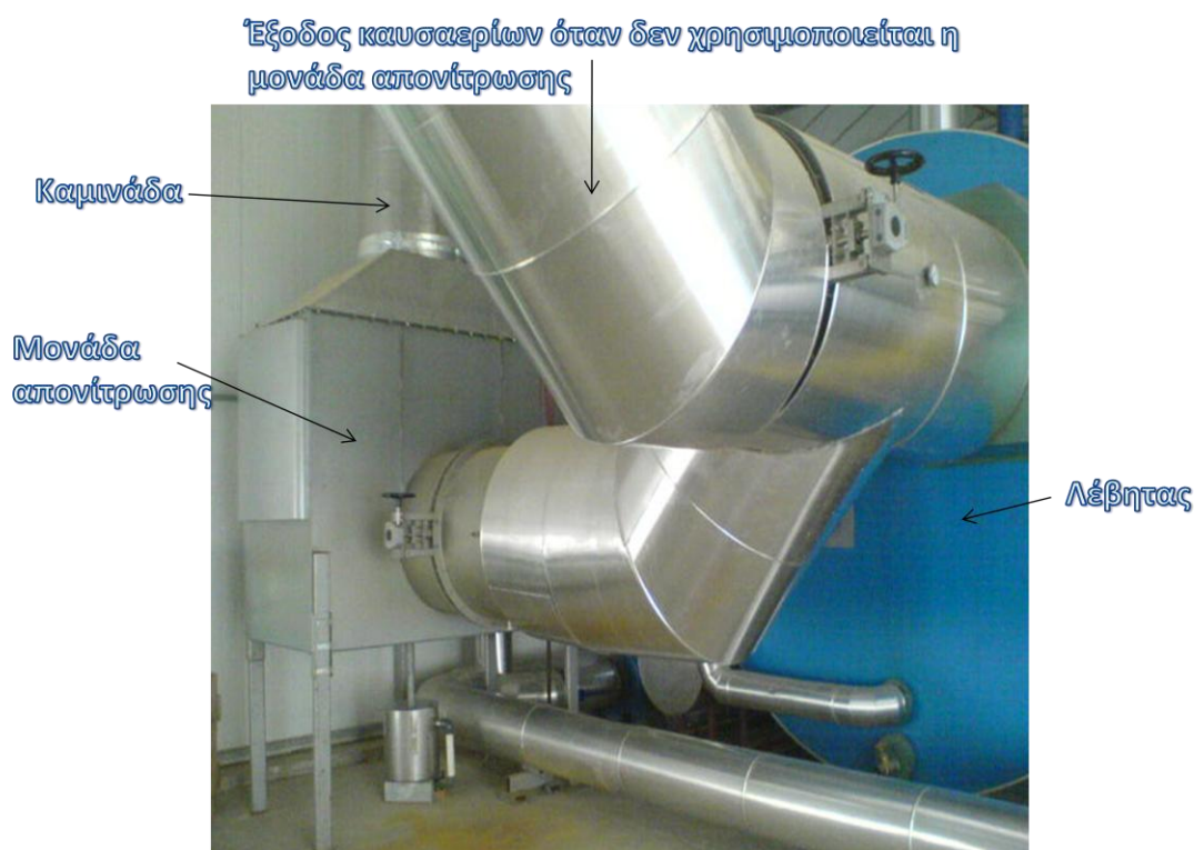
Εικόνα 26: Λέβητες παραγωγής θερμού νερού ( www.dgsa.com.gr )
