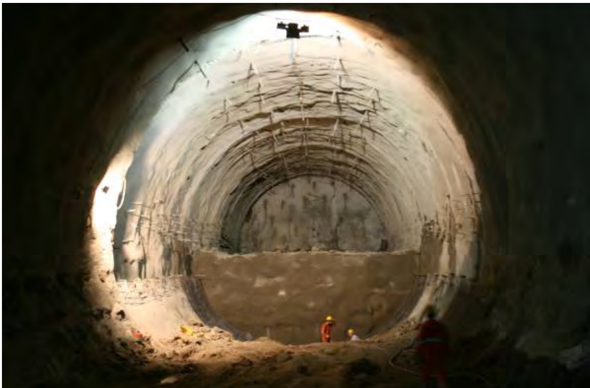
Εικόνα 1.2: Το ενδοτικό – άκαμπτο σύστημα υποστήριξης της σήραγγας Καλλίδρομου.
