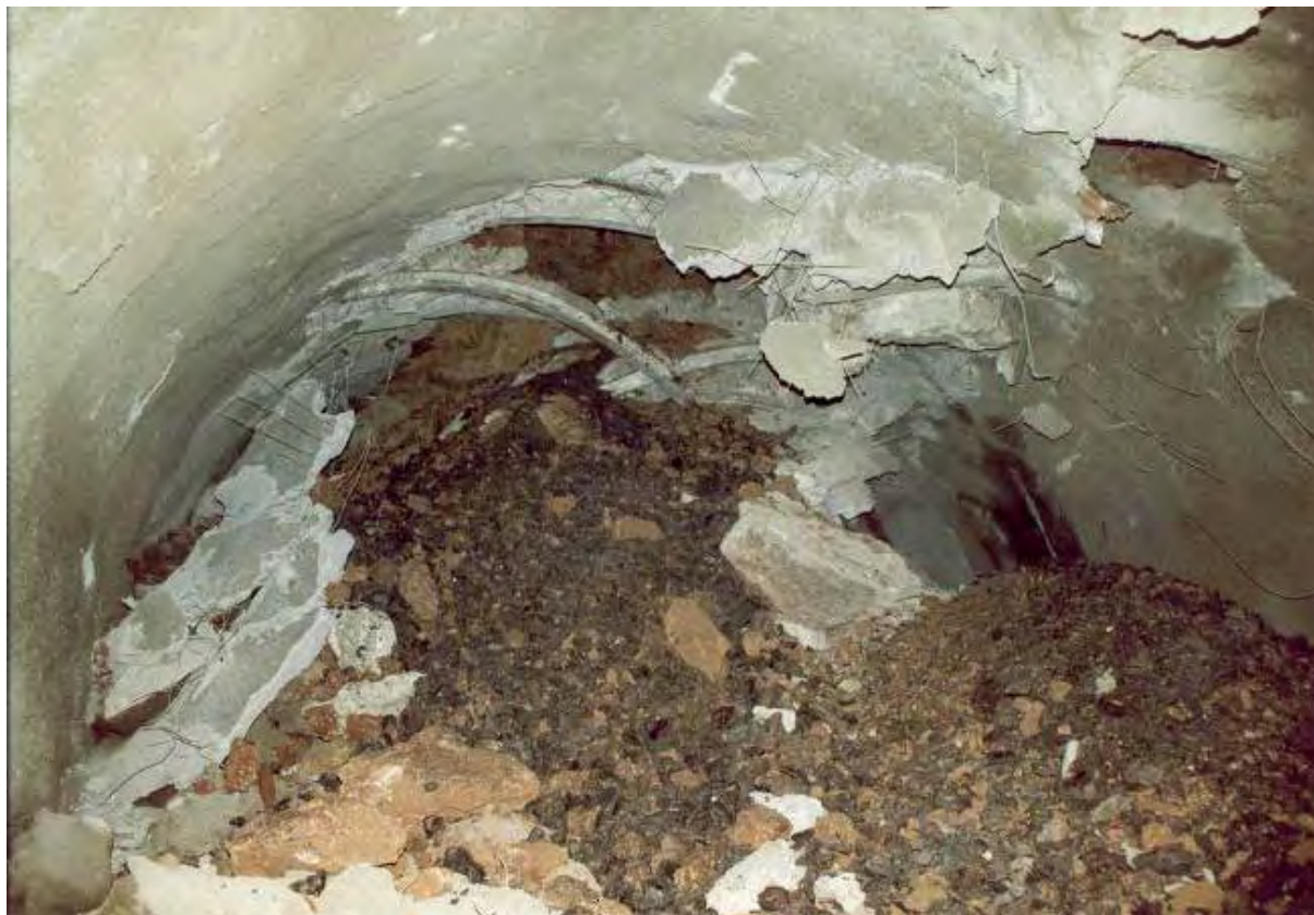
Εικόνα 1.1: Τμήμα του δεξιού κλάδου της σήραγγας Καλλίδρομου, το οποίο έχει καταρρεύσει λόγω σύνθλιψης.
