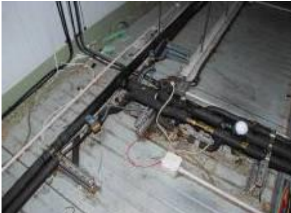
Λάθος τοποθετημένες σωληνώσεις στο δάπεδο ενός ψυκτικού θαλάμου
