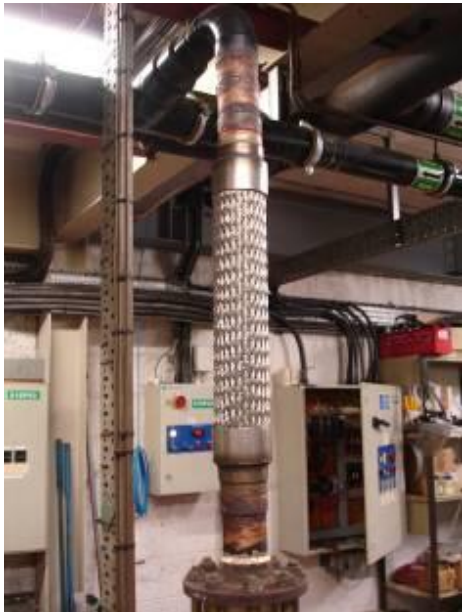
Εσφαλμένη εγκατάσταση εξαρτήματος εξάλειψης κραδασμών
