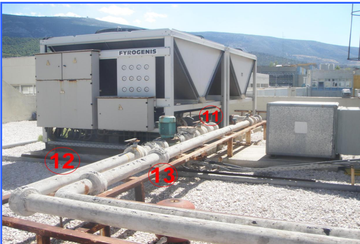
Εικόνα 3: Ψυκτική Εγκατάσταση – Πλάγια όψη
