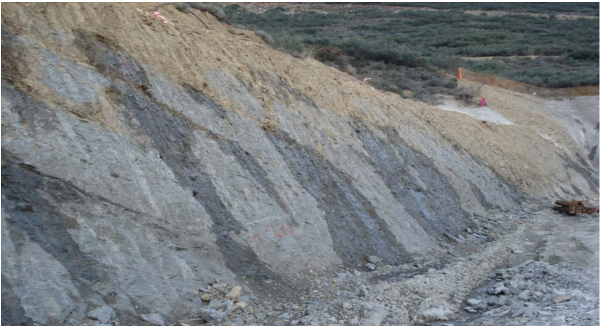
Φωτ.5.5 Στόμια εξόδου, δεξιό πρανάς εμφάνιση υδάτων στην επαφή ψαμμίτη-ιλυόλιθου
