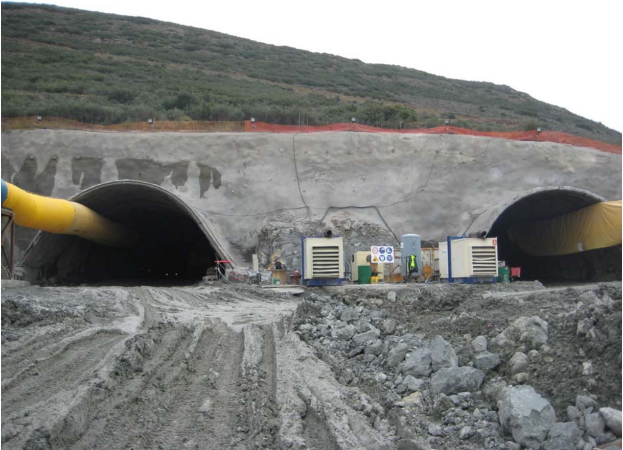
Φωτ.5.7 Στόμια εξόδου, Αποστραγγιστικές οπές - αγκύρια στο μετωπικό πρανές
