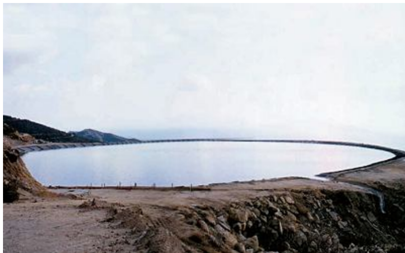
Εικόνα 4.53: Λιμνοδεξαμενή Αγ. Κηρύκου Ικαρίας (Πηγή: ΥΠΑΑΤ)
