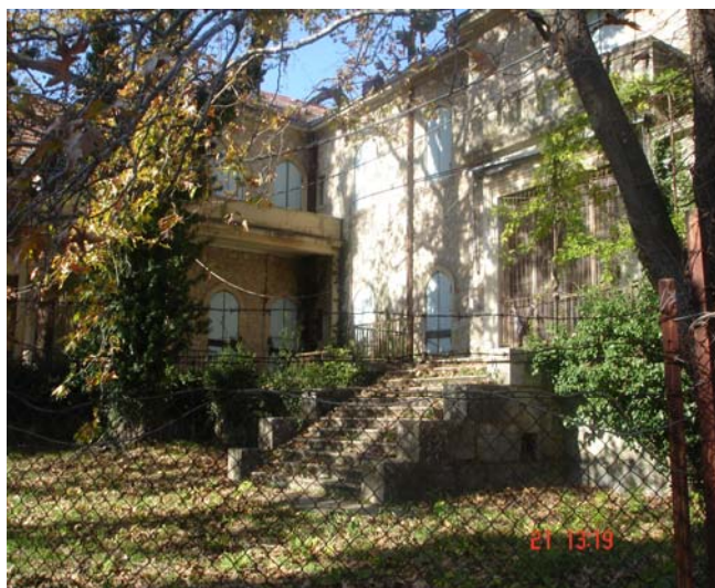
Εικόνα 2.22: Τατόι, Πρώην Βασιλικά Κτήματα, Φθορές στις Προσόψεις των Κτιρίων
