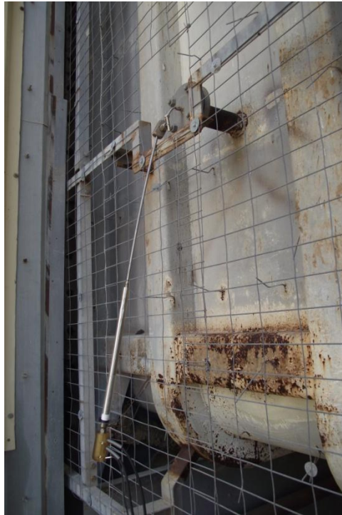
Σχήμα 4.14: τοποθέτηση του flue gas probe για την διεξαγωγή της μέτρησης
