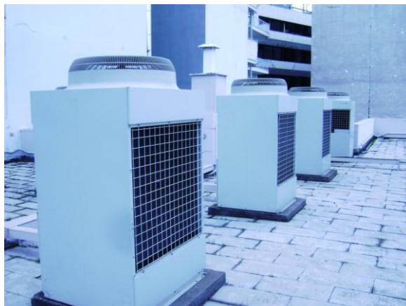
Εικόνα 3.3 : Εξωτερικές μονάδες κλιματισμού/θέρμανσης
