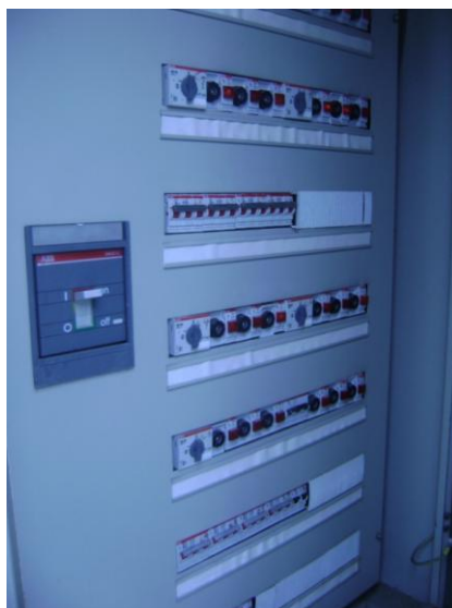
Εικόνα 3.4 : Πίνακας εξωτερικών μονάδων
