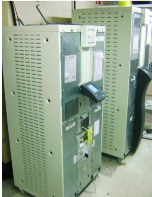
Εικόνα 3.8 : Τα δύο UPS στο μεσοπάτωμα του κτιρίου
