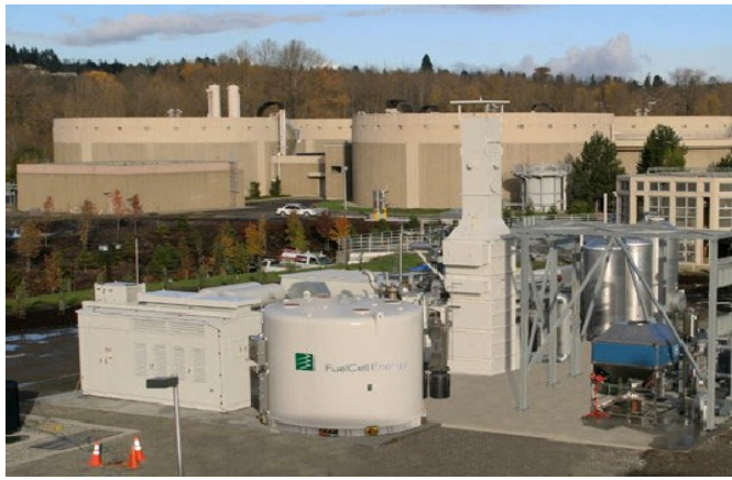
Εικόνα 2-4: Σταθμός παραγωγής ενέργειας με κυψέλες καυσίμου στην Νότια Κορέα
