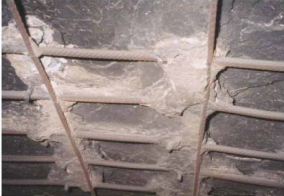
Εικόνα 149 - Αποκόλληση σε τμήμα οροφής (Κατηγορία : Σοβαρή)
