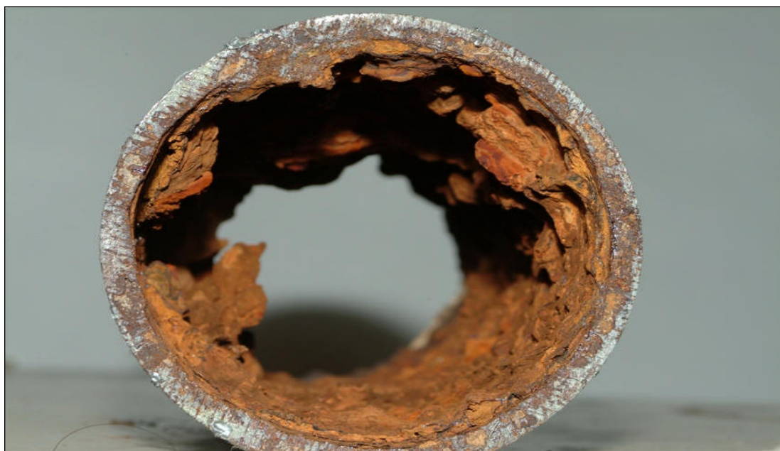
Εικόνα 1.6 Χημική διάβρωση σε αγωγό.
