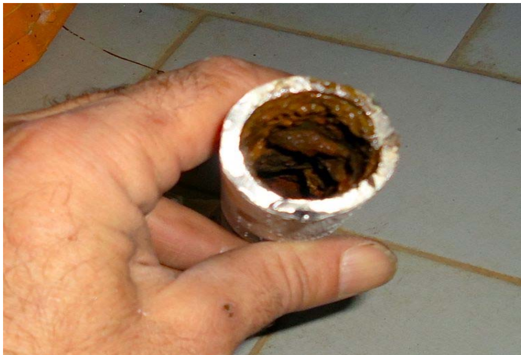
Εικόνα 1.4 Ηλεκτροχημική διάβρωση μέσα σε αγωγό.
