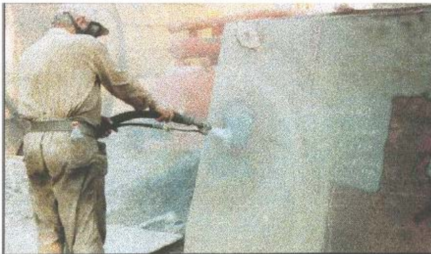
Εικόνα 4.2 Υδροαμβολή με «κουρτίνα» νερού.
