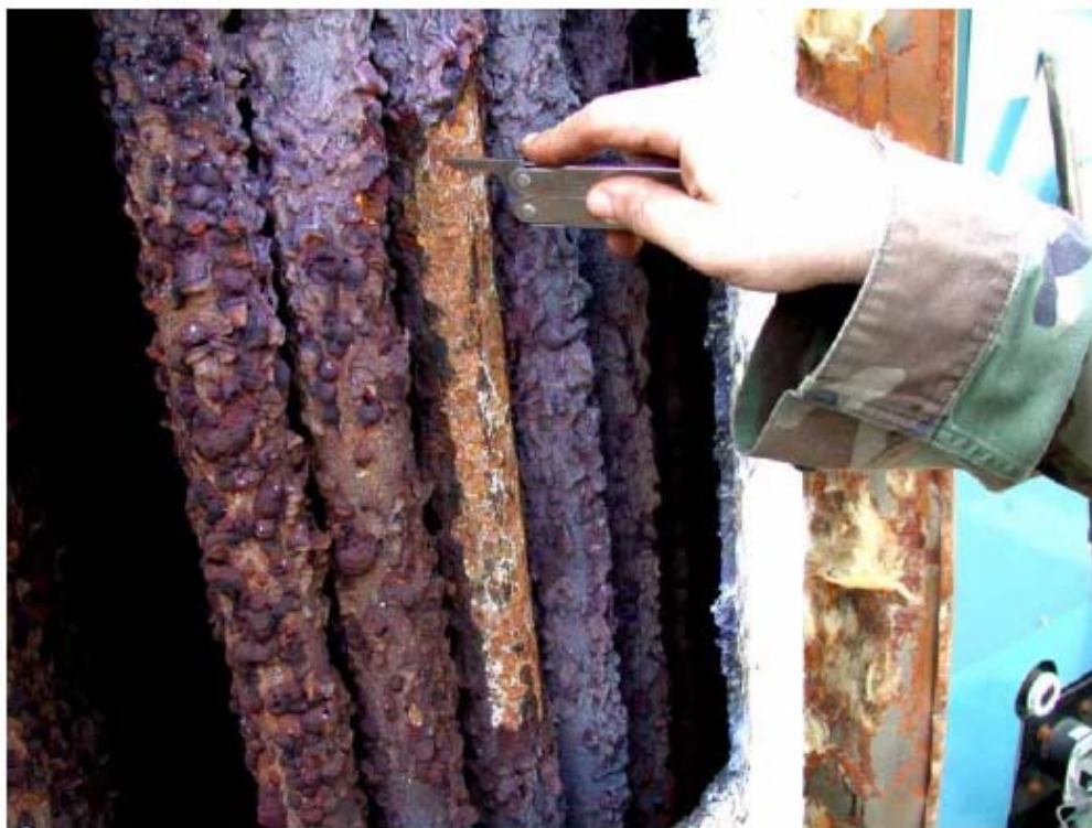
Εικόνα 1.9 Βιολογική διάβρωση (εξωτερικά) σε αυλό προθερμαντήρα νερού.
