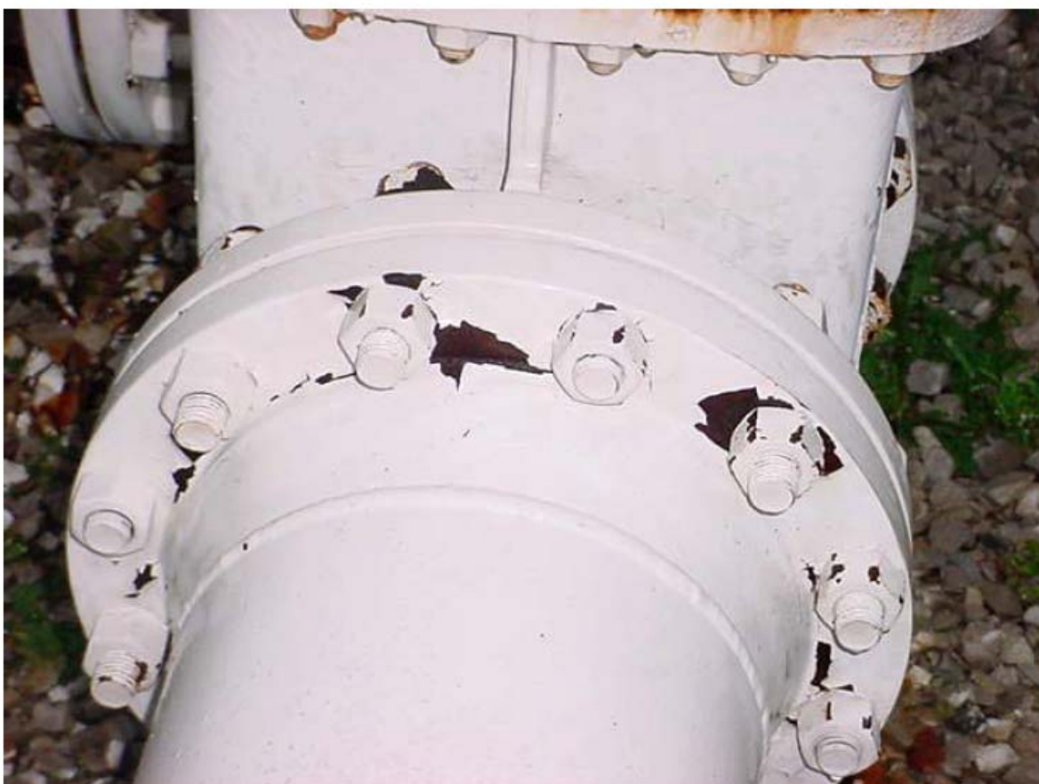
Εικόνα 6.3 Αποφλοίωση χρώματος από φλάντζα αγωγού λόγω του διαβρωτικού περιβάλλοντος.
