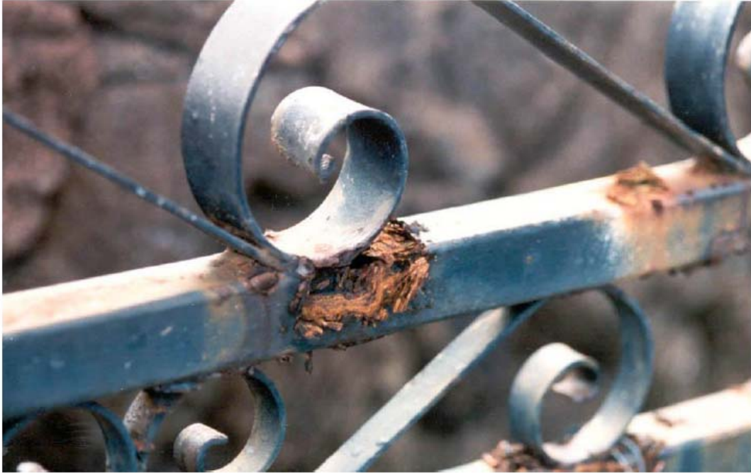
Εικόνα 1.23 Διάβρωση λόγω ύπαρξης διεπιφάνειας.
