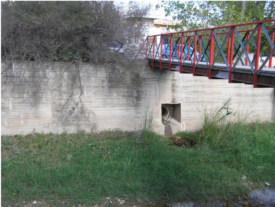
Σχήμα 5.33: Κυκλικός αγωγός του δικτύου ομβρίων που καταλήγει στο ρέμα (Κοψιάτη, 2006)
