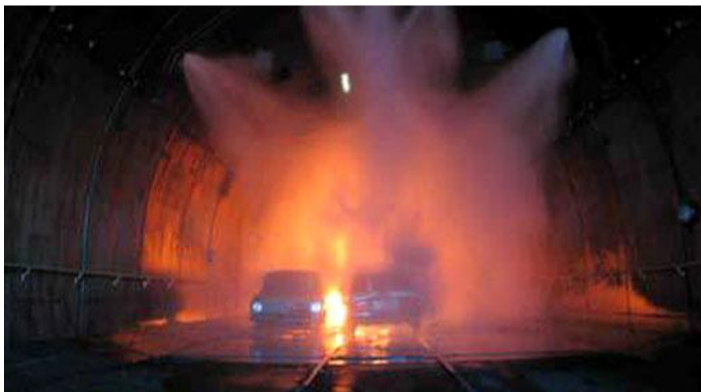
Σχήμα 3-4: Σύστημα καταστολής πυρκαγιάς με ομίχλη νερού
