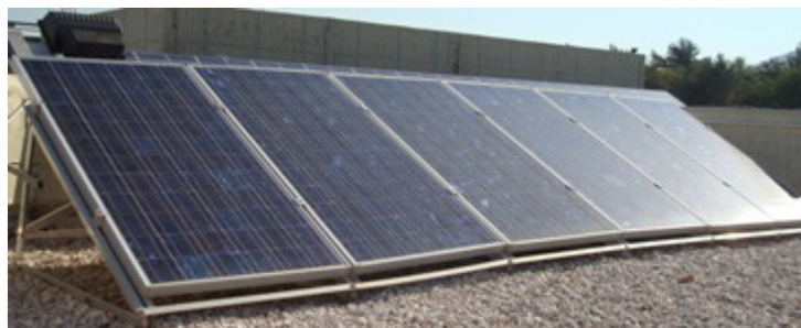
Σχ. 7.1. Φ/Β συστοιχία αποτελούμενη από έξι Φ/Β πλαίσια τύπου Sharp NEQ5E3E και μέγιστης ισχύος 165 W στο δώμα του κτιρίου του τμήματος Ηλεκτρολόγων Μηχανικών και Μηχανικών Υπολογιστών ΕΜΠ.
