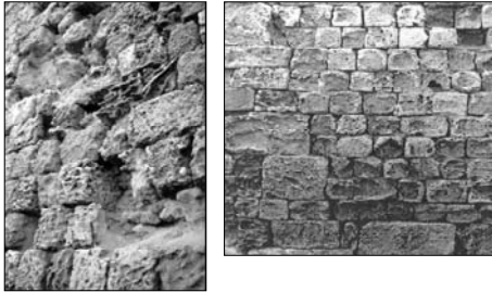
Κρυστάλλωση αλάτων - Κυψέλωση
