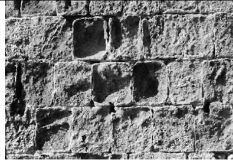
Ασυμβατότητα - τσιμεντικά κονιάματα αποκατάστασης
