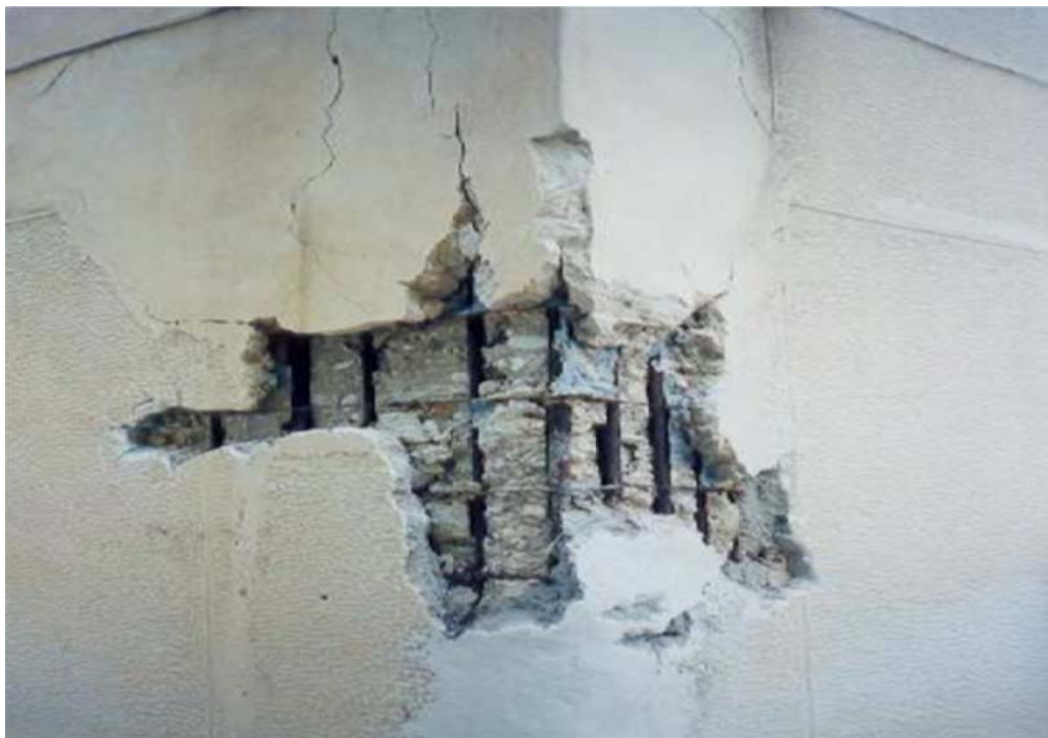
Σχήμα I.6. Επιφανειακή ρηγμάτωση του σκυροδέματος λόγω προσβολής χλωριόντων [7]
