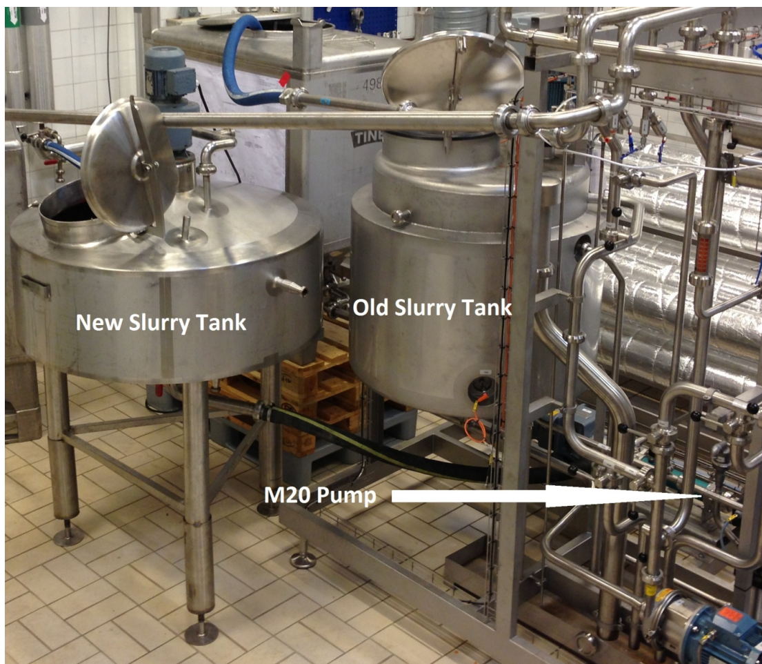
Εικόνα 25: Η παλιά και η νέα Δεξαμενή "Πολτού" (Slurry Tank) και η σύνδεση της τελευταίας με την αντλία M20
