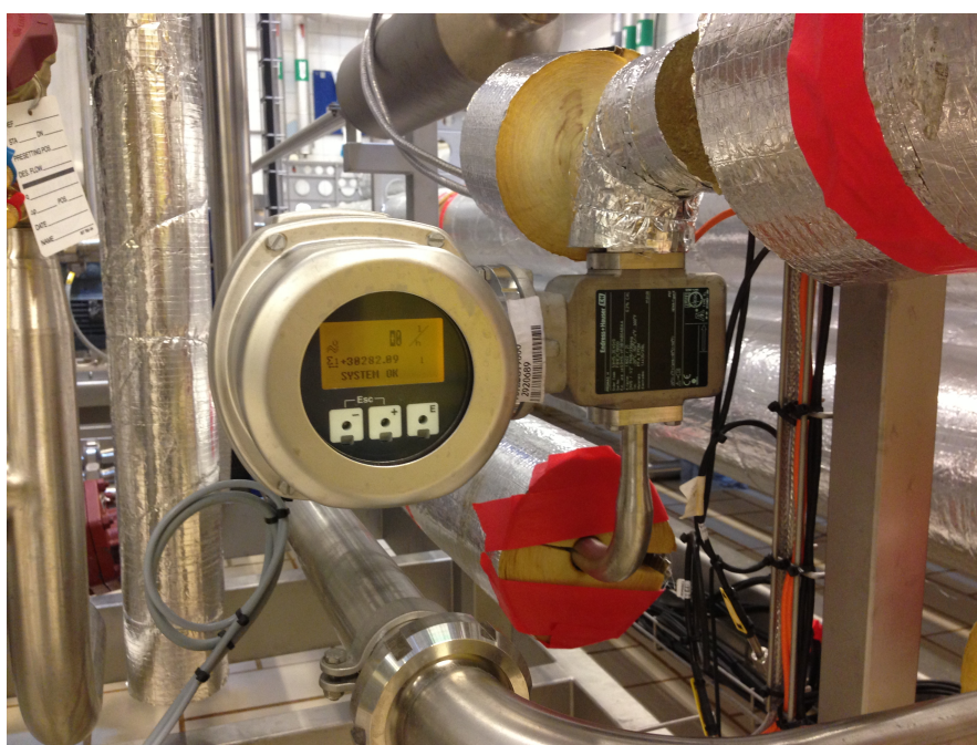
Εικόνα 21: Ροόμετρο που μετρά την ογκομετρική παροχή του ρεύματος φέροντος ρευστού (FT10)
