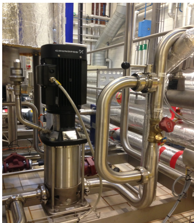
Εικόνα 20: Φυγοκεντρική αντλία (M44) που χρησιμοποιείται για την ανακυκλοφορία του θερμού νερού στο κλειστό κύκλωμα του εξωτερικού τοιχώματος του σωληνωτού εναλλάκτη
