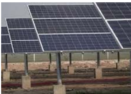
Εικόνα 3.7-5: Φωτοβολταϊκή συστοιχία που αποτελείται από φ/β πάνελα των 3 φ/β πλαισίων [45].
