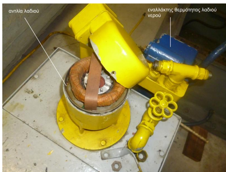
Σχήμα 3-12: Το εσωτερικό της αντλίας
