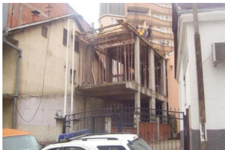
Εικόνα 5.3 : Κτίριο με αυθαίρετη κατασκευαστική προσθήκη
