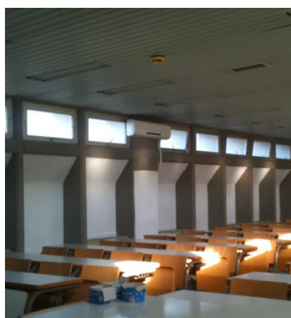
Εικ. 9.58: Κλιματιστικό σώμα στο αναγνωστήριο της στάθμης 2 της πτέρυγας Α
