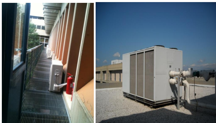
Εικ. 9.57: Εξωτερικές μονάδες κλιματισμού των εργαστηρίων της πτέρυγας Δ και Κεντρική μονάδα κλιματισμού του αμφιθεάτρου
