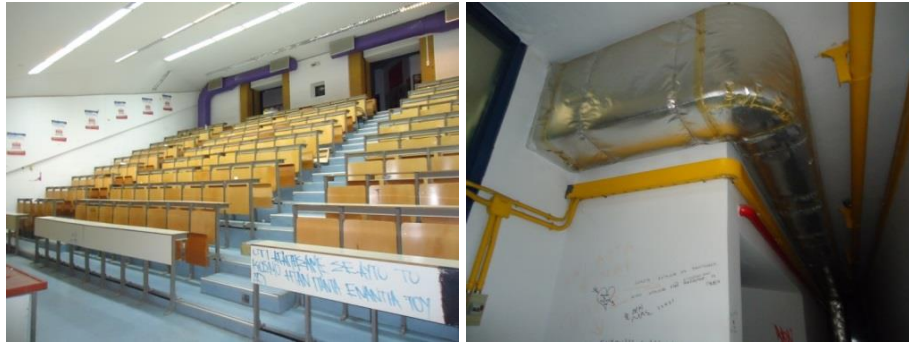
Εικ. 9.54: Αεραγωγοί για τη θέρμανση του αμφιθεάτρου
