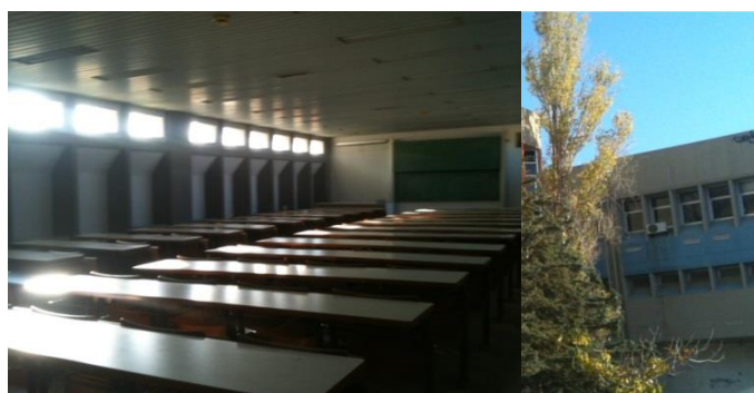
Εικ. 9.42: Παράθυρα στο επάνω μέρος της αίθουσας στο αναγνωστήριο της στάθμης 2 της πτέρυγας Α
