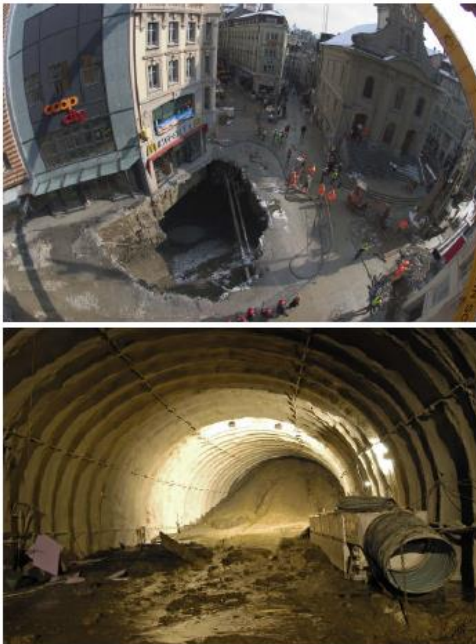
Εικόνα 2-1. Αστοχία μετώπου αβαθούς σήραγγας κατά την κατασκευή του Μετρό της Λωζάννης (Stallmann, 2005)
