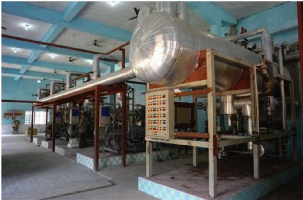
Εικόνα 4.26 Μονάδα ατμοποιητή τυμπάνου σε μηχανοστάσιο ψυκτικής εγκατάστασης
