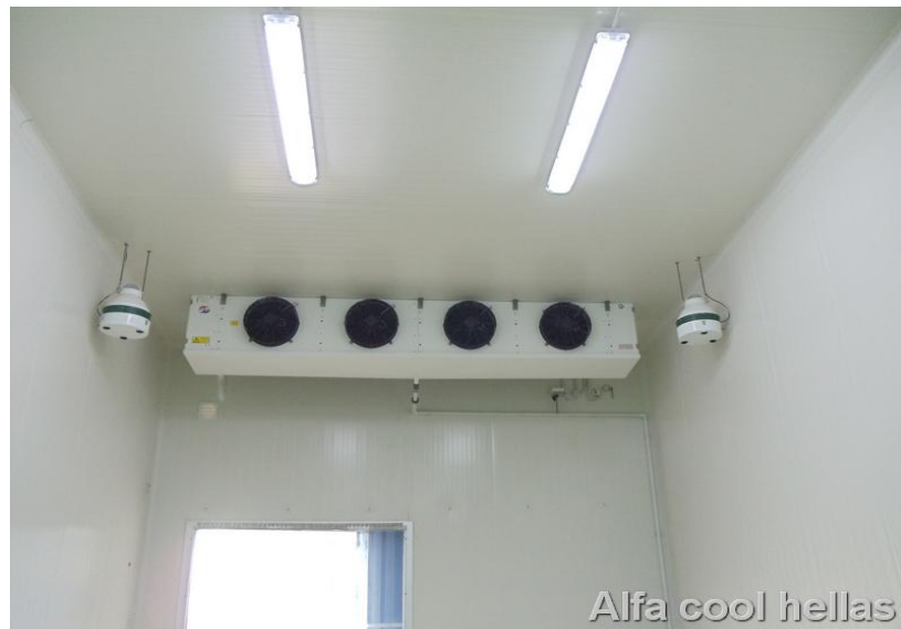
Εικόνα 4.11 Τοποθέτηση fan-coil αξονικής ροής πάνω από τη θύρα του θαλάμου (Πηγή: http://www.alfacoolhellas.gr )
