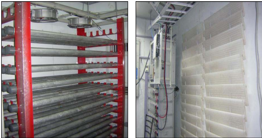
Σχήμα 3.28: Εφεδρεία AC για καταφύγιο τηλεπικοινωνιών σε σωλήνες αλουμινίου (αριστερή εικόνα), εγκατεστημένο PCM σε καταφύγιο τηλεπικοινωνιών για εφεδρεία AC στους 29°C (δεξιά εικόνα)
