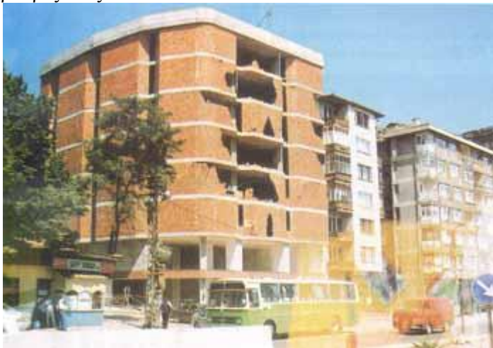
Εικόνα 5.3: Κτήριο με βλάβες στην τοιχοποιία πλήρωσης, Αφιερώματα ΤΕΕ, τεύχος 2067 (Ο σεισμός της Τουρκίας 1999)
