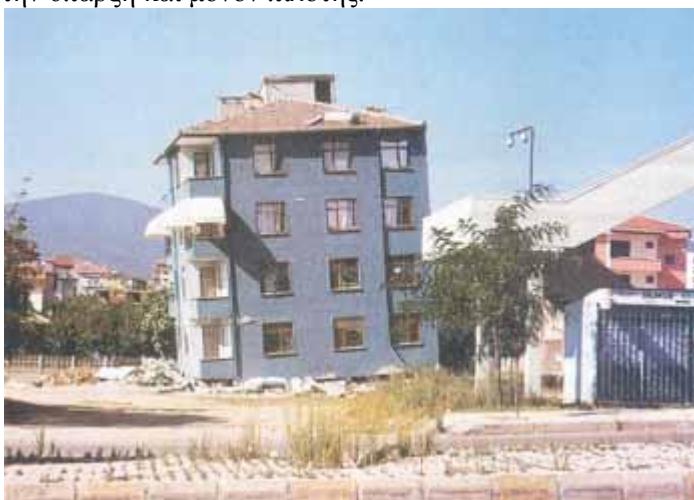
Εικόνα 5.2 :Κτήριο στο Adarazari με πυλωτή που συνεθλίβη, Αφιερώματα ΤΕΕ, τεύχος 2067 (Ο σεισμός της Τουρκίας 1999)
