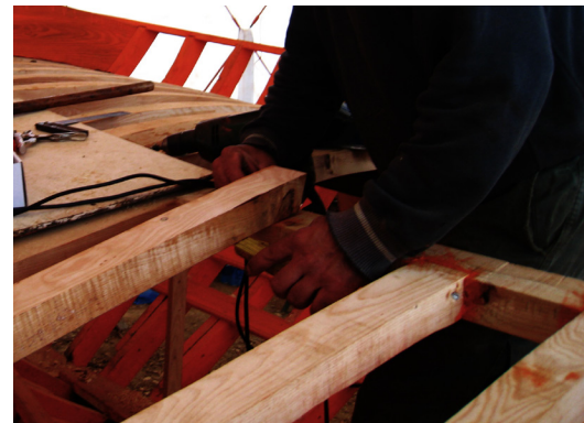
144. Η 'μέγκα', η ειδική ένωση μεταξύ μισοκάμαρων και διαμήκων δοκαριών στη διαμόρφωση των ταμπούκιων
