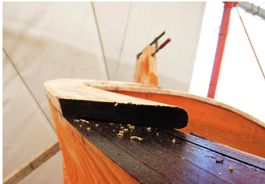
168. Λεπτομέρεια της συναρμογής της κουπαστίς με την κατωκουπαστή, το αστάρι και το μπακαλάρι
