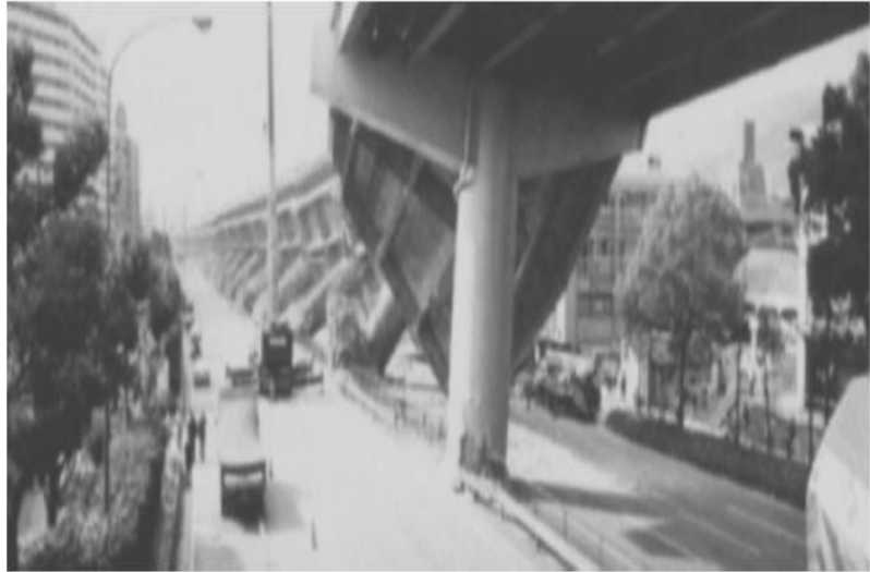
Εικόνα 2.2 : Καμπτική αστοχία μονόστυλων κυκλικών βάθρων του αυτοκινητόδρομου Hanshin στο σεισμό του Kobe, Ιαπωνία, το 1995
