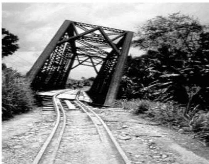
Εικόνα 2.4 : Υποχώρηση θεμελίωσης σε σιδηροδρομική γέφυρα
