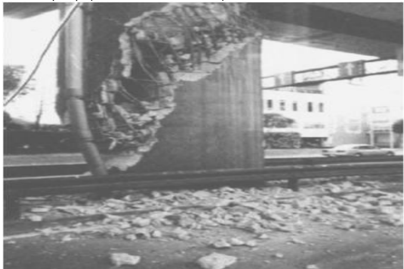
Εικόνα 2.3 : Διατμητική αστοχία βάθρου γέφυρας στο σεισμό του Kobe, Ιαπωνία, το 1995
