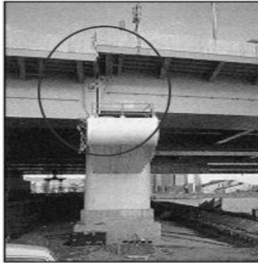
Εικόνα 2.5 : Πλευρική μετατόπιση 1m του βάθρου, εξαιτίας ρευστοποίησης του εδάφους θεμελίωσης
