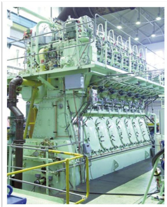
Σχήμα 1.8 Δίχρονος κινητήρας Diesel σε μονάδα παραγωγής ηλεκτρικού ρεύματος
