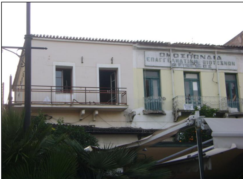
Εικόνα 6-42: διατηρητέο κτίριο στο κέντρο της πόλης το οποίο έχει μερικώς ανακατασκευαστεί πηγή: προσωπικό αρχείο
