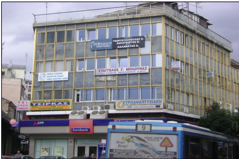
Εικόνα 6-44: κτίριο που χρήζει εργασίες συντήρησης και αναβάθμισης της αισθητικής του - άναρχη τοποθέτηση πινακίδων πηγή: προσωπικό αρχείο
