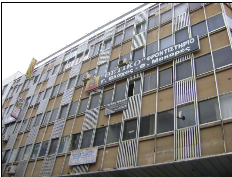
Εικόνα 6-48: κτίριο που χρήζει εργασιών για την βελτίωση της αισθητικής του. πηγή: προσωπικό αρχείο
