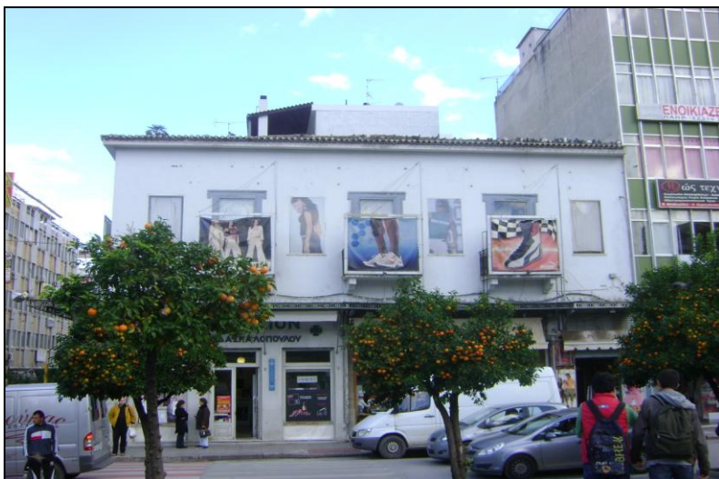
Εικόνα 6-45: κτίριο που χρήζει εργασίες συντήρησης και αναβάθμισης της αισθητικής του - άναρχη τοποθέτηση πινακίδων πηγή: προσωπικό αρχείο
