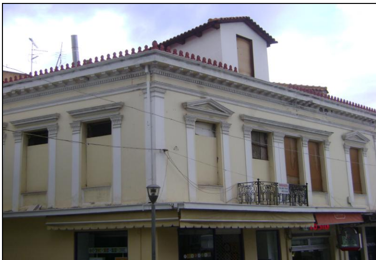
Εικόνα 6-47: διατηρητέο κτίριο στο κέντρο της πόλης με ημιτελής εργασίες αναπαλαίωσης του. πηγή: προσωπικό αρχείο
