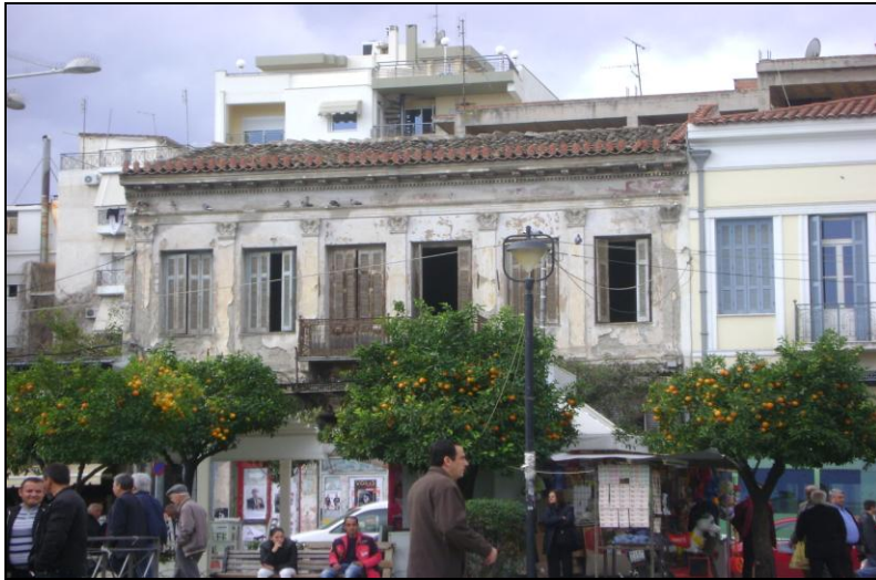
Εικόνα 6-43: εγκαταλελειμμένο διατηρητέο κτίριο στο κέντρο της πόλης. πηγή: προσωπικό αρχείο
