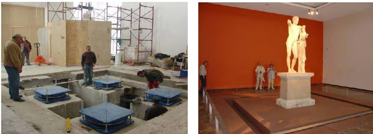
Σχήμα 2.16 Σεισμική μόνωση αγάλματος Ερμή του Πραξιτέλη σε εφέδρανα ανεστραμμένου εκκρεμούς.
