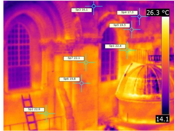
Θερμογράφημα 12: Θερμογράφημα που αντιστοιχεί στην περιοχή εντός του πλαισίου της Εικόνας 12
