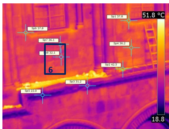
Θερμογράφημα 8: Θερμογράφημα που αντιστοιχεί στην περιοχή εντός του πλαισίου της Εικόνας 8
