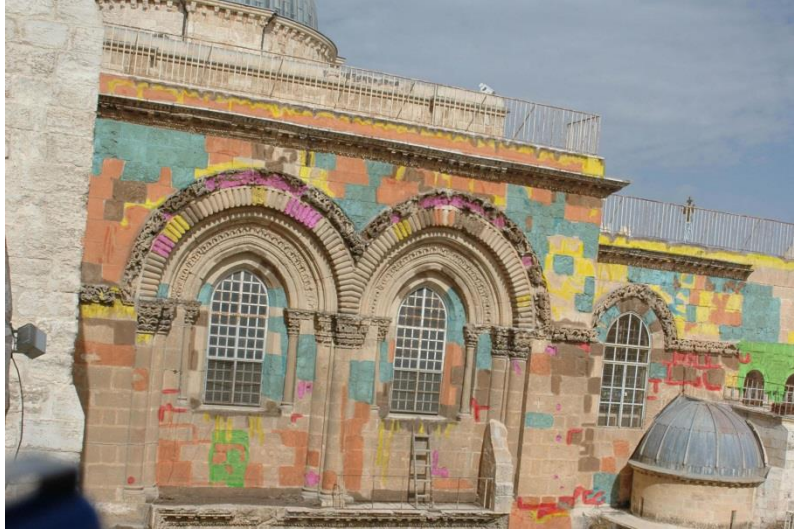
Εικόνα 4.4: Χαρτογράφηση της φθοράς στο επάνω τμήμα της νότιας όψης του Ιερού Ναού της Αναστάσεως
