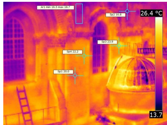
Θερμογράφημα 13: Θερμογράφημα που αντιστοιχεί στην περιοχή εντός του πλαισίου της Εικόνας 13
