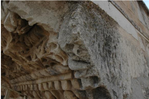
Εικόνα 3.10: Επιφάνεια με μαύρους και κίτρινους σχηματισμούς που οφείλονται στη βιοδιάβρωση
