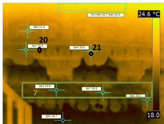
Θερμογράφημα 35: Θερμογράφημα που αντιστοιχεί στην περιοχή εντός του πλαισίου της Εικόνας 35
