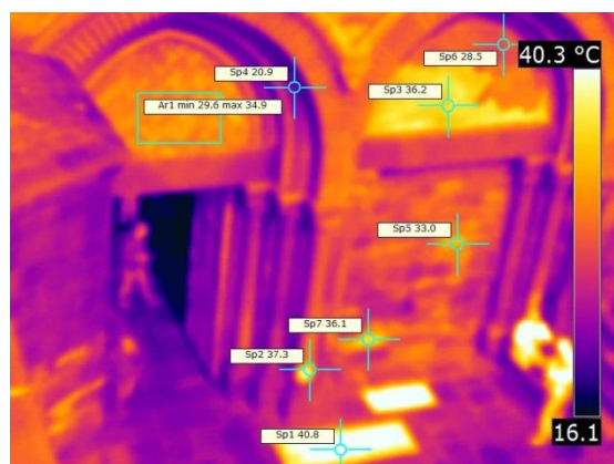
Θερμογράφημα 19: Θερμογράφημα που αντιστοιχεί στην περιοχή εντός του πλαισίου της Εικόνας 19
