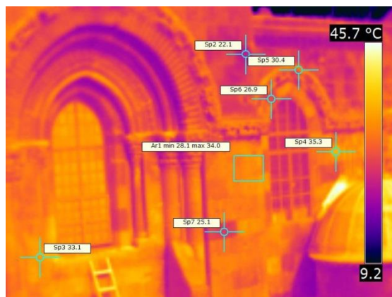
Θερμογράφημα 11: Θερμογράφημα που αντιστοιχεί στην περιοχή εντός του πλαισίου της Εικόνας 11
