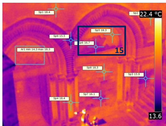
Θερμογράφημα 23: Θερμογράφημα που αντιστοιχεί στην περιοχή εντός του πλαισίου της Εικόνας 23
