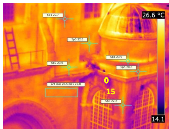
Θερμογράφημα 15: Θερμογράφημα που αντιστοιχεί στην περιοχή εντός του πλαισίου της Εικόνας 14
