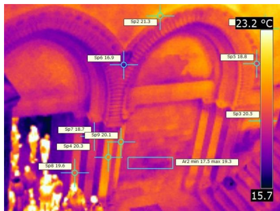
Θερμογράφημα 21: Θερμογράφημα που αντιστοιχεί στην περιοχή εντός του πλαισίου της Εικόνας 21
