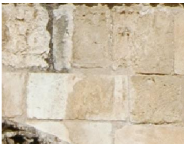
Εικόνα 3.4: Διαφορετικοί τύποι φθοράς στην τοιχοποιία γύρω από τα παράθυρα της νότιας όψης
