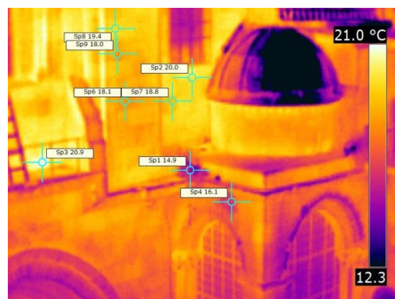
Θερμογράφημα 18: Θερμογράφημα που αντιστοιχεί στην περιοχή εντός του πλαισίου της Εικόνας 18
