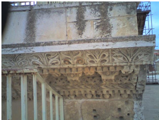
Εικόνα 30: Ανατολική όψη της πρόσοψης του Ιερού Ναού της Αναστάσεως. Ημερομηνία: 27.1.2011, Ώρα:13.21, Θερμοκρασία: 22°C
