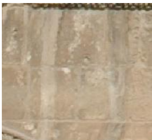
Εικόνα 3.5: Λευκοί σχηματισμοί στην τοιχοποιία που έχουν προκληθεί από τη ροή του νερού
