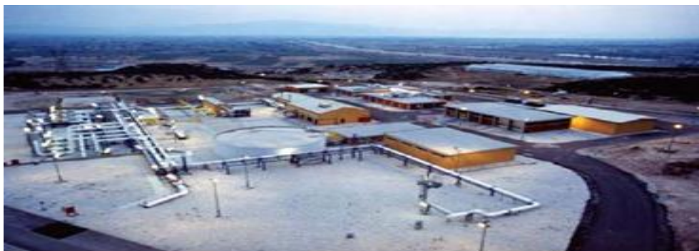
Εικόνα 2.1 Σταθμός Σιδηροκάστρου (ΔΕΣΦΑ, Μελέτη Ανάπτυξης ΕΣΦΑ 2013-2022, 2012)
