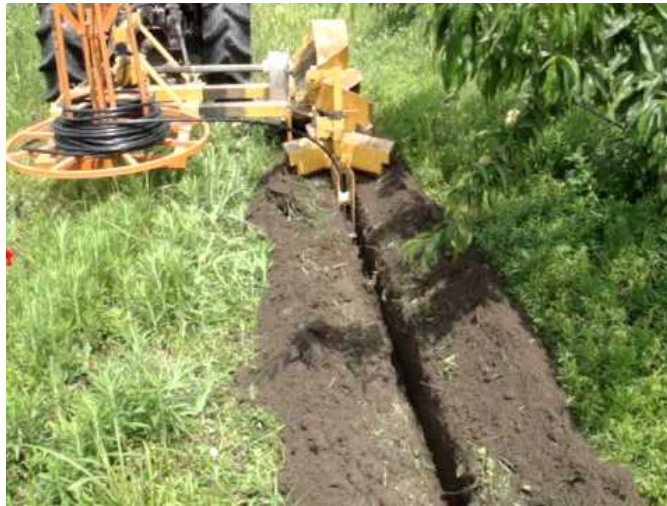
Εικόνα 5.4: Υπόγεια στάγδην άρδευση
