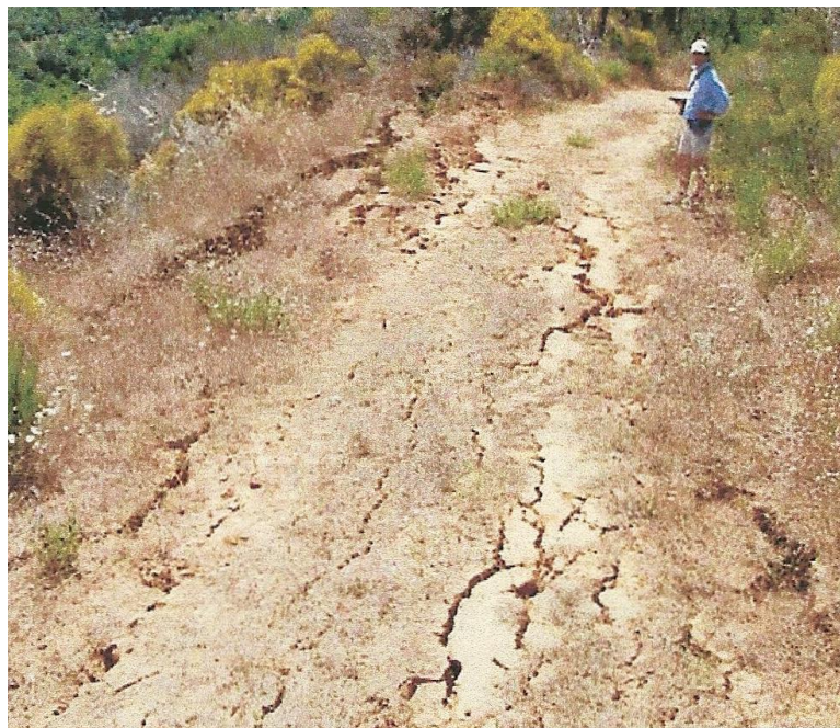
Εικόνα 5.43: Επιφανειακή ζώνη ρωγματώσεων Δυτικά του χωριού Μιχόι
