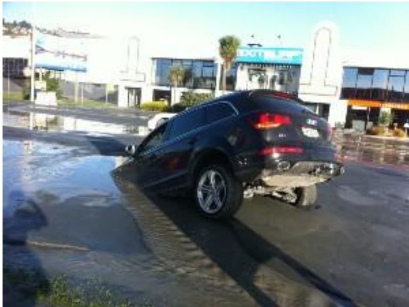
Εικόνα 4.3. Φαινόμενα ρευστοποίησης κατά το σεισμό του Christchurch Νέας Ζηλανδίας το 2010
