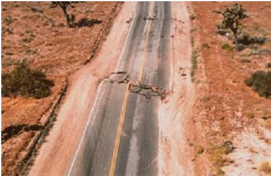
Εικόνα 5.30 Επιφανειακές σεισμικές διαρρήξεις και αστοχίες σε δρόμους στη διέλευση του ρήγματος του σεισμού Landers and Big Bear
