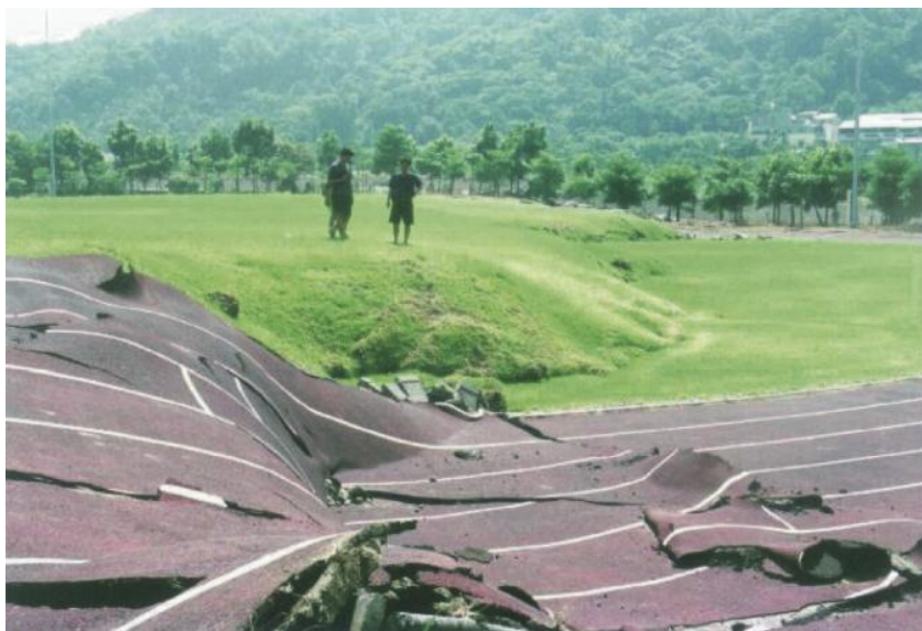
Εικόνα 5.55. Επιφανειακές ρωγματώσεις από το σεισμό της Taiwan
