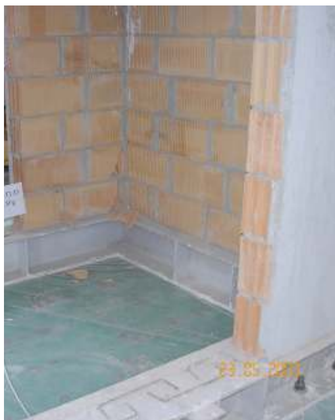
Εικόνα 16: Θλιπτική αστοχία τύπου λικνισμού («rocking»)
