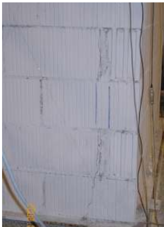
Εικόνα 4: Θλιπτική αστοχία στη 14η δοκιμή (0,48g)
