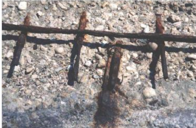
Σχ.2.13: Διάβρωση μεταλλικών αντικειμένων στο έδαφος
