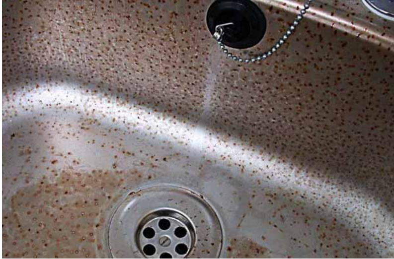
Σχ. 2.7: Έντονη διάβρωση με βελονισμούς σε νιπτήρα βιομηχανικής εγκατάστασης
