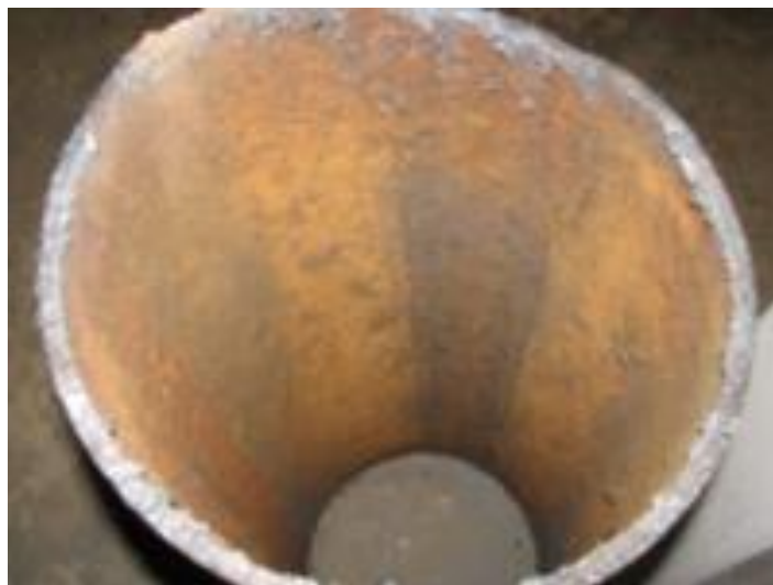
Σχ.2.6: Ομοιόμορφη διάβρωση μεταλλικού σωλήνα
